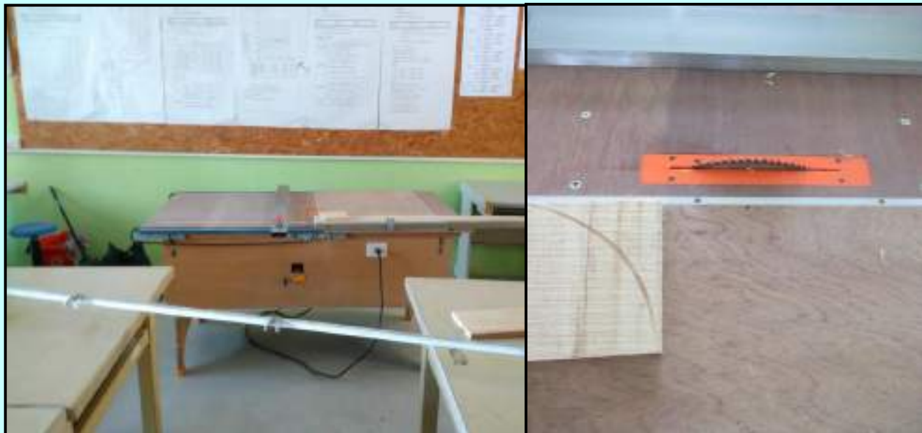
所使用木材加工用圓盤鋸未設置反撥預防裝置及鋸齒接觸預防裝置
